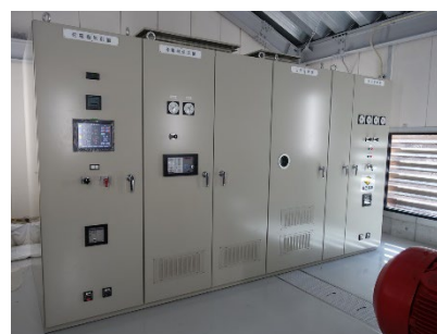
(発電機操作盤)
