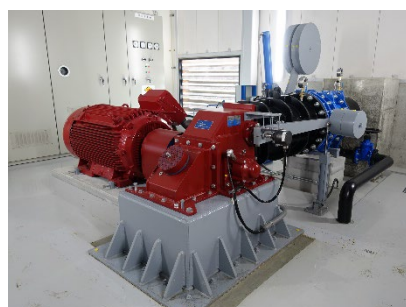
(水車・発電機)
