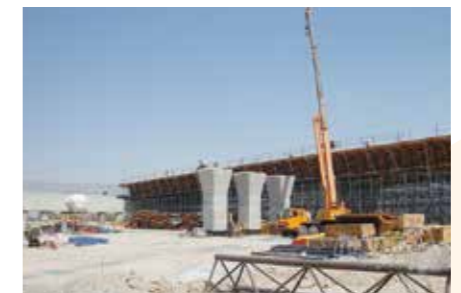
交差道路の地下化、幹線道路の高架化へ向けた工事の様子。
