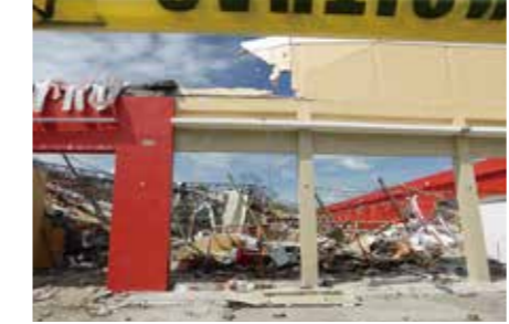
台風により倒壊した家屋など。
