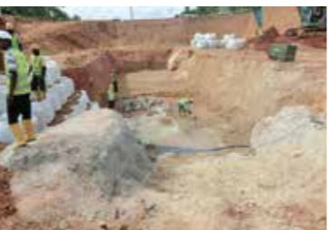
スリランカの岩塊・岩盤の出現は予測しにくいいため設計変更が多発する。
