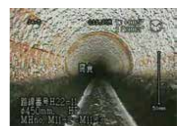
腐食が進むと道路陥没の危険性があるため、早急な対策が必要となる。
