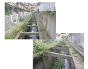
左) 擁壁で嵩上げされた宅地とマンションの間の狭い柵渠。 右) 左右の高さがずれ、切梁が斜めになっている。
