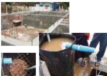
上) 浄水場の建設が急ピッチで進む。 下) 緩速濾過施設前処理として、ヤシガラを使用した粗ろ過の試験を実施。
