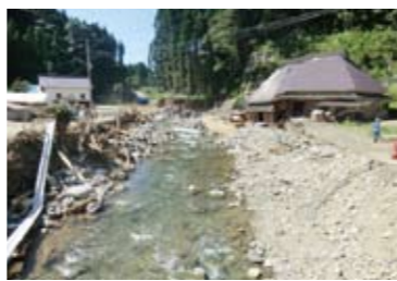
平成24年7月、梅雨前線の活動が活発化し、熊本県阿蘇付近を中心に福岡県から大分県の広範囲で降った豪雨。死者を含む甚大な被害をもたらした。九州支店では災害復旧事業の全工程に携わった。
